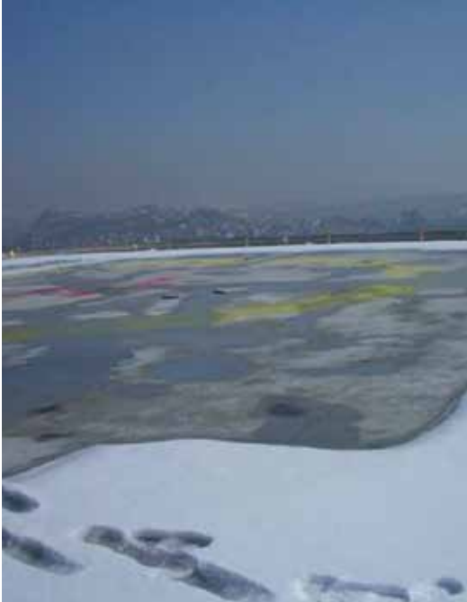
Büyükşehir Belediyesi Binası Helikopter Pisti Kar-Buz Birikimini Engelleme Sistemi ANKARA
