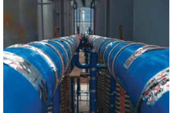
İba Valressa Boya Fabrikası - Boru Isıtması Sistemi ANKARA
