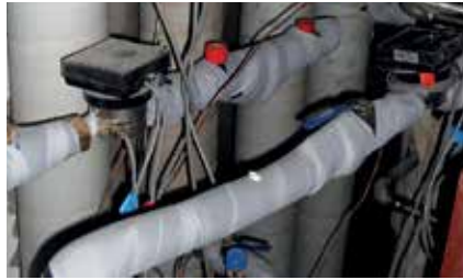
Danfoss ASV balans vanaları ve kalorimetreler dört daireden oluşan her grup için teknisyen odalarında kurulmuştur.
